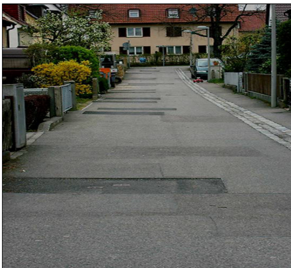
Bild 4: „Flickenteppich nach Aufgrabungen (FGSV)“
